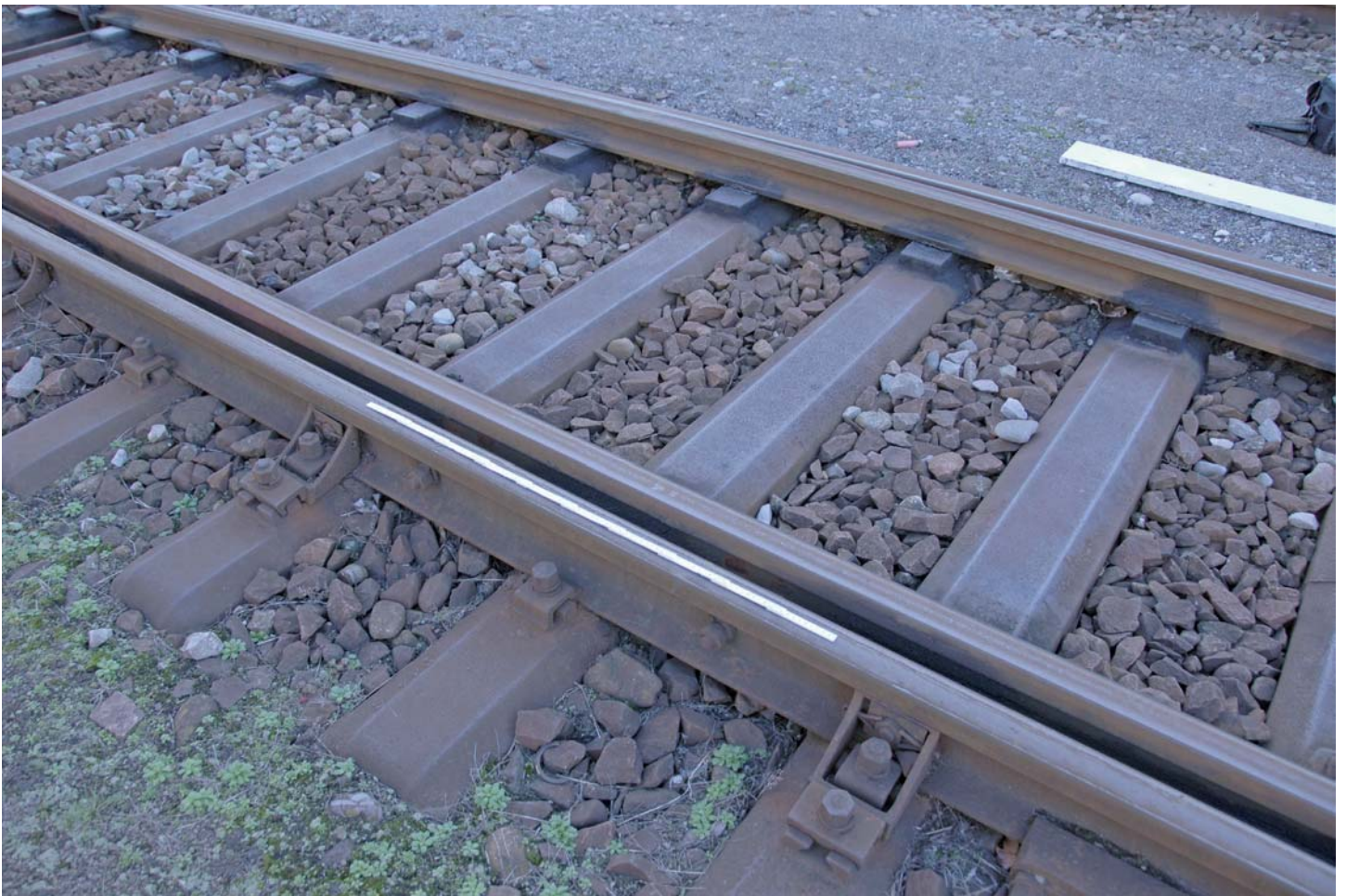
Gleitplatten und Schienenstützen
